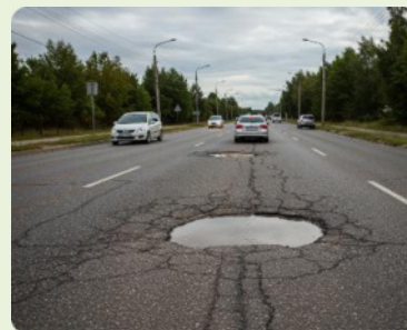
Imaginea 6: Suprafață carosabilă deteriorată
